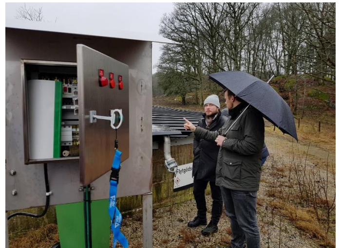
Helgi Héðinsson oddviti og Guðjón Vésteinsson skipulagsfulltrúi skoða geymslutank fyrir svartvatn og hvernig staðið er að dælu og hreinsun.
